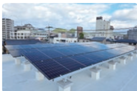
太陽光パネル
